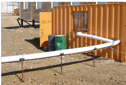
Figura 3. Tubería congelada que requiere calentamiento, Estación Progress.
