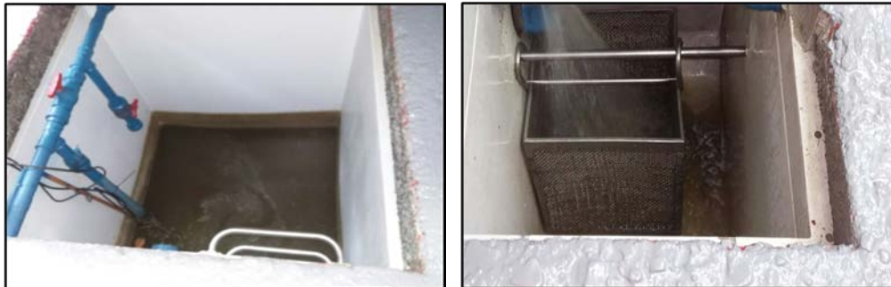
Figura N° 9 Cámara elevadora y cámara de rejillas
